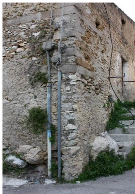
In Figura: In alto, sezione muraria; In basso, cantonale in conci informi successivamente modificato con elementi in calcestruzzo
